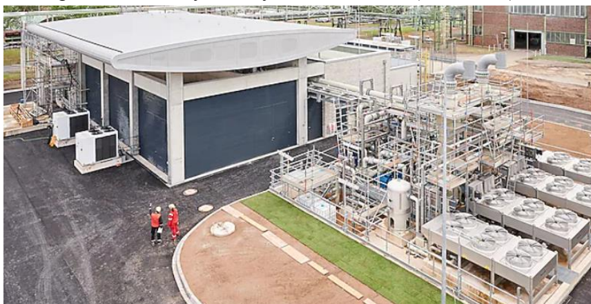
Obr. 3: Elektrolyzátor REFHYNE o výkonu 10 MW s pevnou polymerní membránou pro výrobu zeleného vodíku [5].
