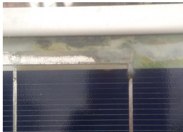
Obr. 7: Koroze na měděné sběrnici panelu.
