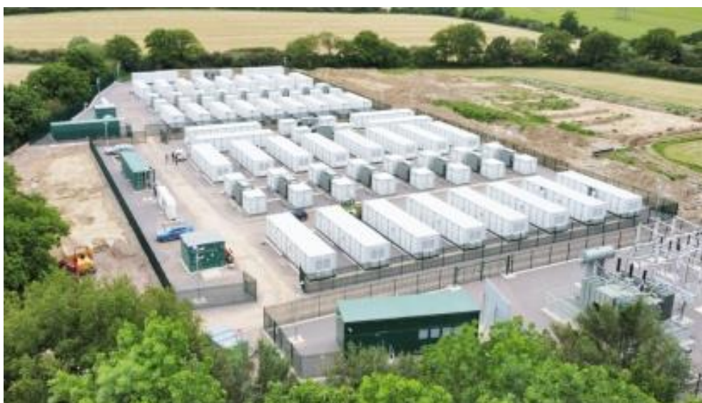
Obr. 1: Vysokokapacitní úložiště Minety s aktuální kapacitou 100 MWh a plánovaným rozšířením až na 150 MWh [2].
