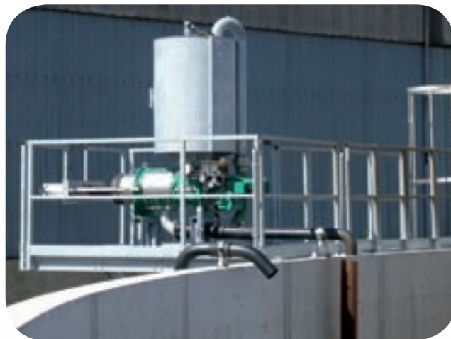
Umístění separátoru na skladovací jímce
